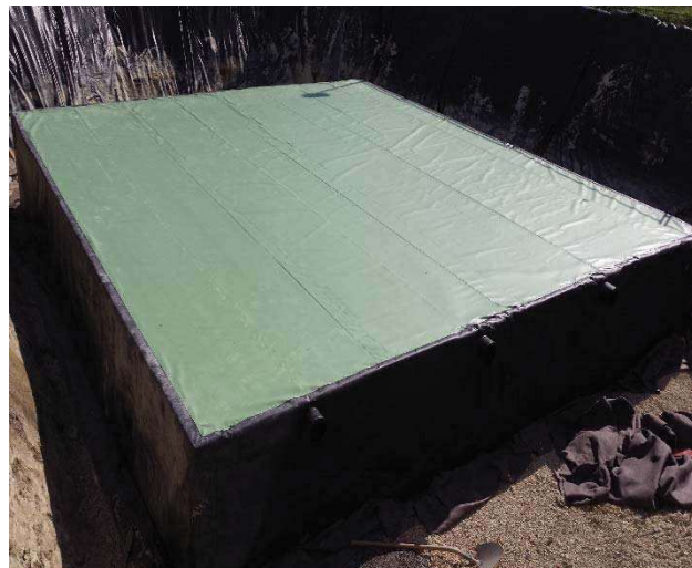
Figure 10 : Bassin totalement étanche
