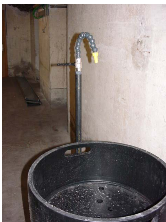
Fosse de rinçage et de décantation
