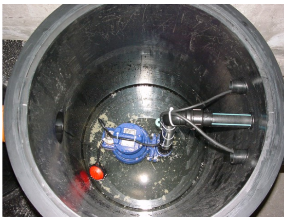
Fosse de rétention et pompe de relevage
